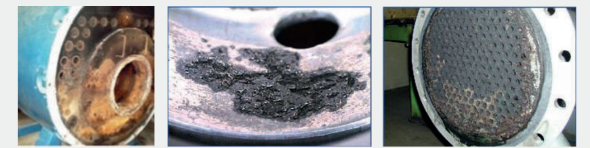
Imágenes. Corrosión en motor debido al H 2 S. (Fuente: MWM)
